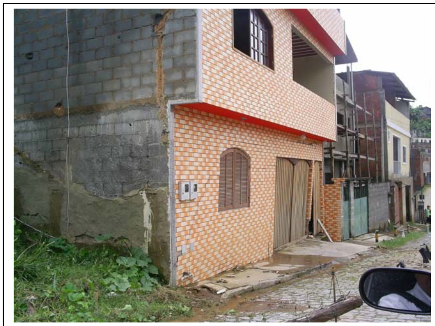
Foto 05 – Prédio em fase inicial de deformação pelo processo de rastejo no dia 08 de janeiro de 2007
