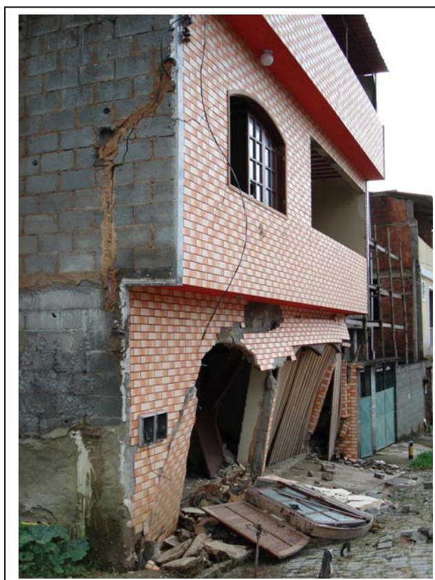
Foto 06 – Mesmo prédio em estágio mais avançado de deformação no dia 19 de janeiro de 2007
