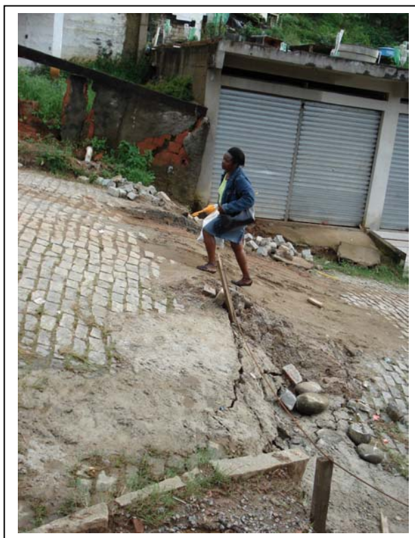
Foto 03 – Trinca de tração com desnível superior a 0,50m que marca o limite Este da área em processo de ruptura.
