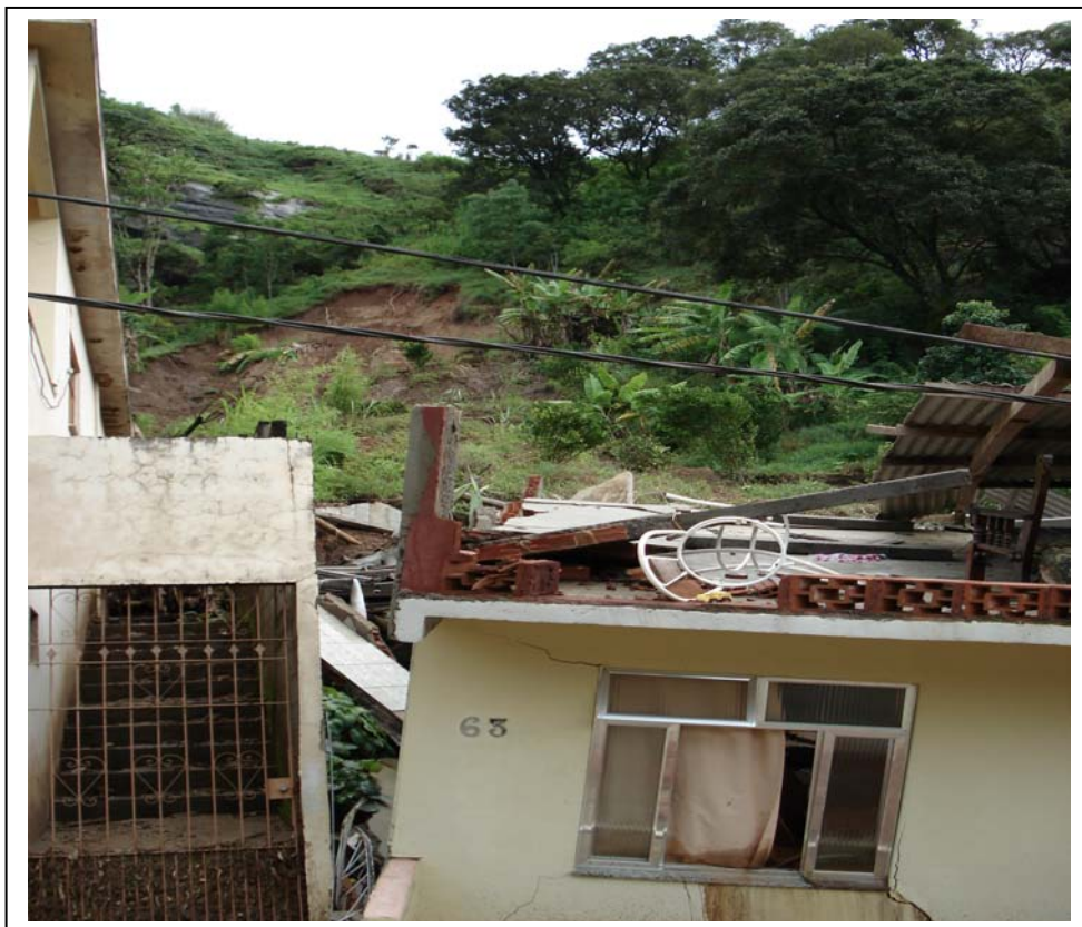
Foto 02 – Ruptura inicial no talude a montante da moradia
