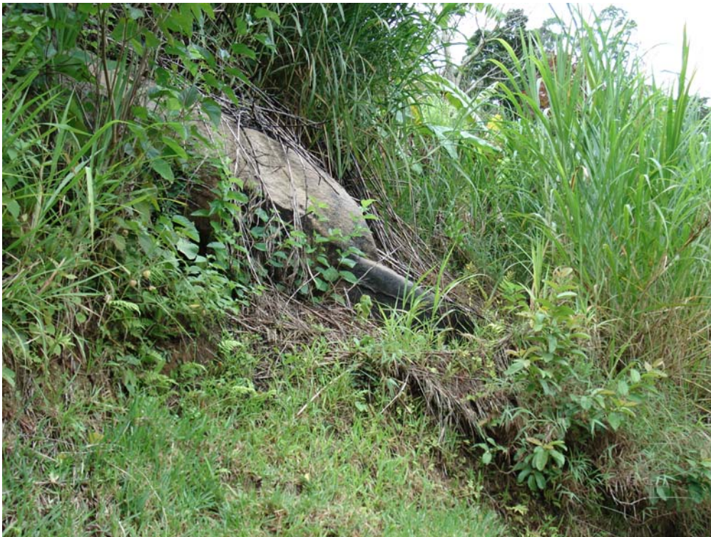
Foto 04 – Bloco de rocha de cerca de 1\text{m}^3 na encosta logo acima de residência na rua Santa Marta, Jardim Ouro Preto.
