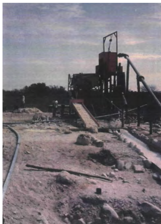
Figura 26 – Planta de beneficiamento de minério Ourotec M-10 em operação. Fonte: MORAES, 1998.
