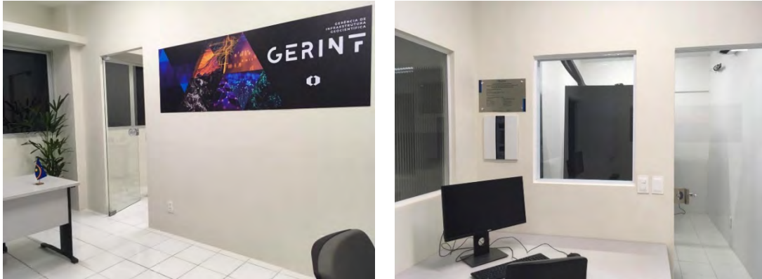
Padronização das salas de TI
