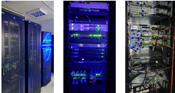
Fotos dos equipamentos do CPD Urca reestruturado com cabeamento certificado
