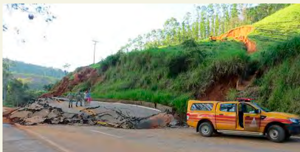
Deslizamento rotacional na rodovia BR-259 em dezembro de 2013 (Baixo Guandu, ES).
