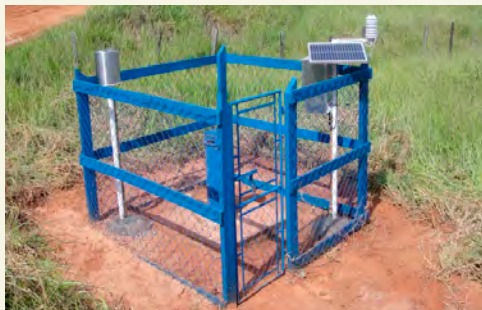
Plataforma de coleta de dados instalada junto ao poço de monitoramento.
