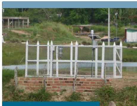
PCD com sensores de chuva, temperatura e umidade relativa do ar, instalada na estação pluviométrica de IF-CATU.
