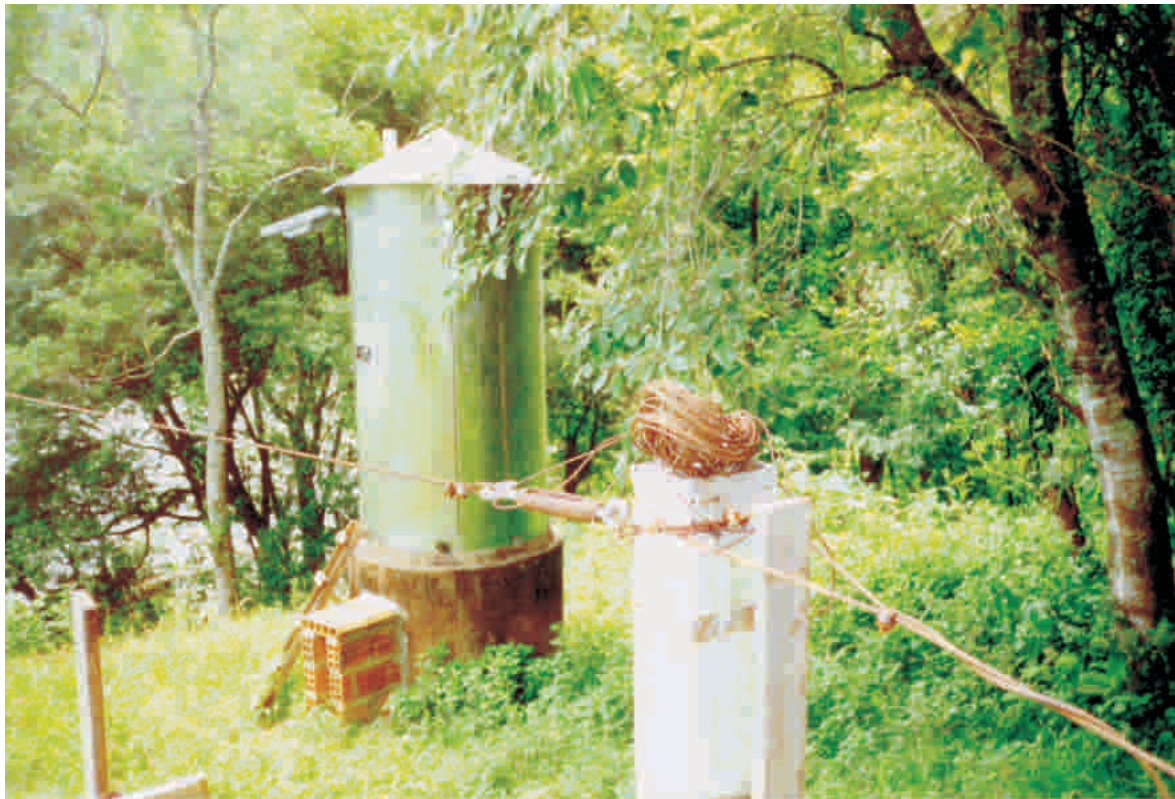
Estação pluvio-fluviométrica de Passo do Socorro, Rio Grande do Sul, conjugada com medições de qualidade de água e com sistema telemétrico
