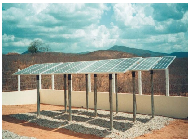
Coletor solar de corrente contínua, em Livramento, município de Irauçuba, CE.
