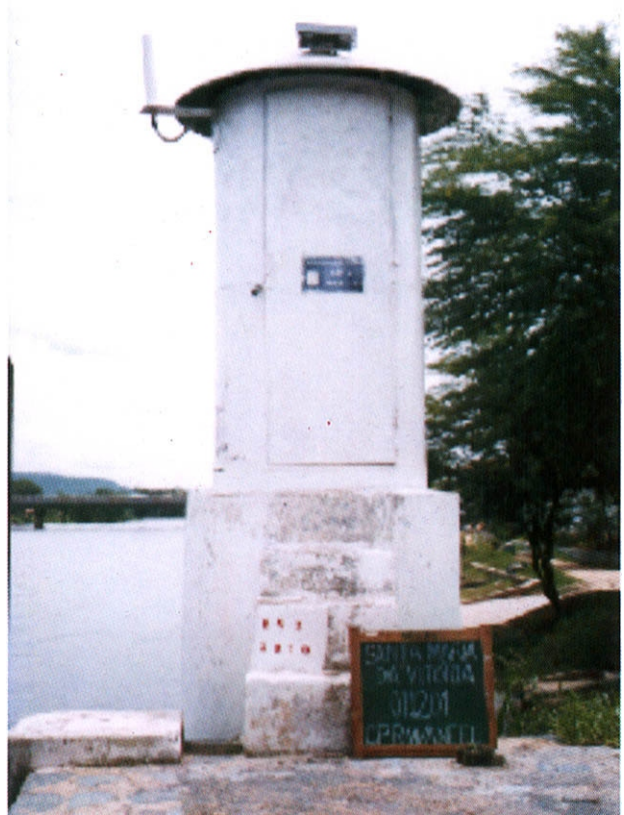
Plataforma de coleta de dados, com transmissão via satélite, instalada na estação linigráfica de Santa Maria da Vitória, BA, às margens do Rio São Francisco.
