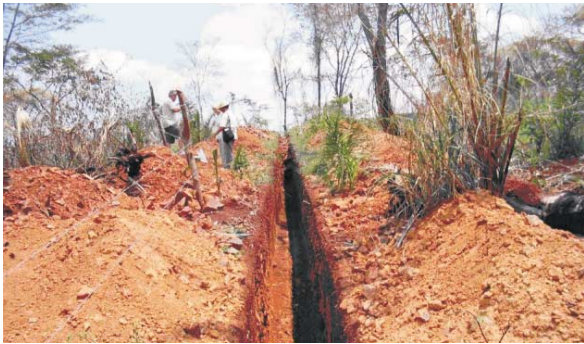
Aspecto de uma trincheira para coleta de amostras na pesquisa de carbonatitos da região de Planalto da Serra (MT). Projeto Avaliação de Rochas Calcárias e Fosfatadas para Insumos Agrícolas do Estado de Mato Grosso.
