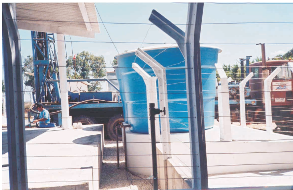
SSA - Sistema Simplificado de Abastecimento Implantado.
