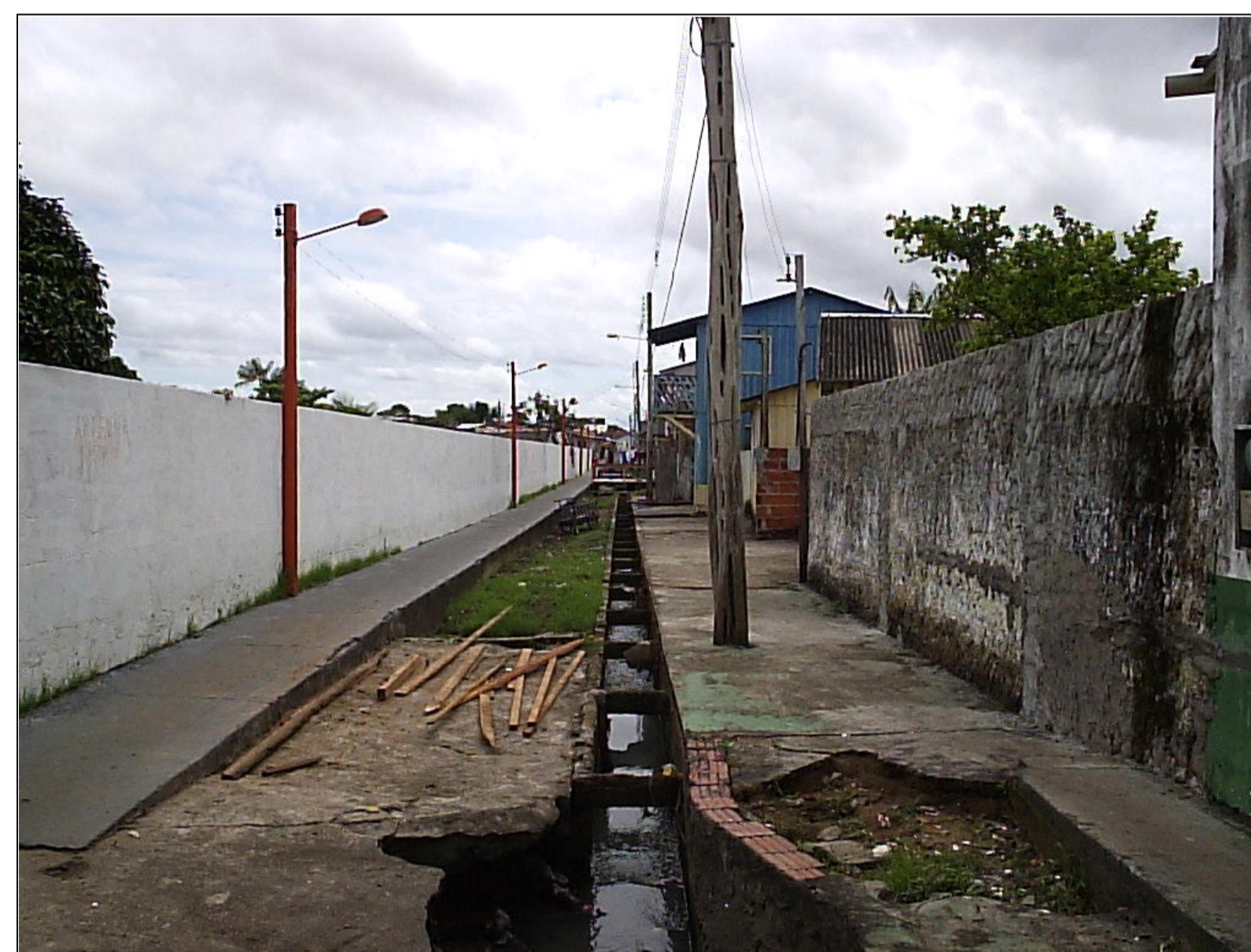
Figura 4: Vala de esgoto a céu-aberto correndo ao lado do muro do terreno onde estão situados os poços públicos da Estação de Bombeamento Paraíba.
