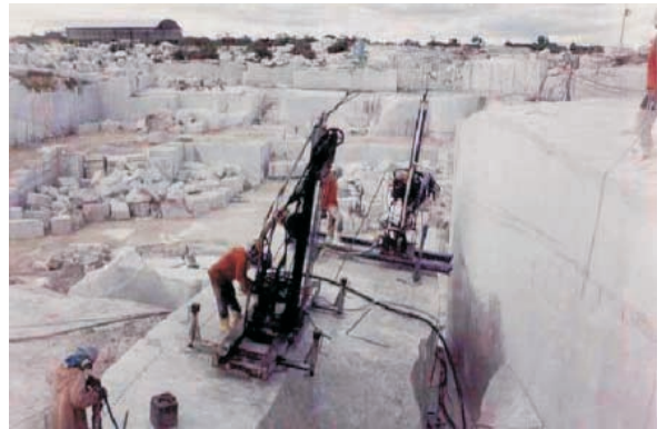
Aspectos de uma frente de lavra do granito branco Ceará clássico, produzido pela empresa Granistone S/A, no município de Santa Quitéria (CE). Projeto Quixadá.
