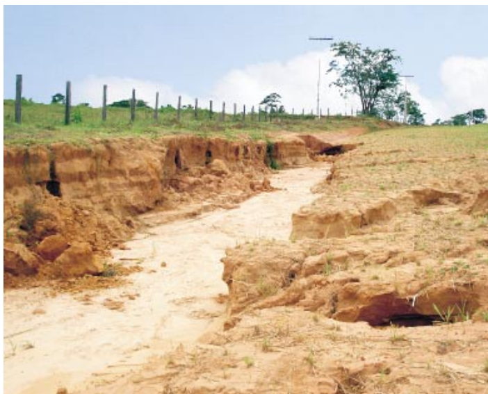
Erosão na forma de ravina, evoluindo para voçoroca, em obra de abertura do anel viário, na localidade do Amapá, município de Rio Branco (AC).
