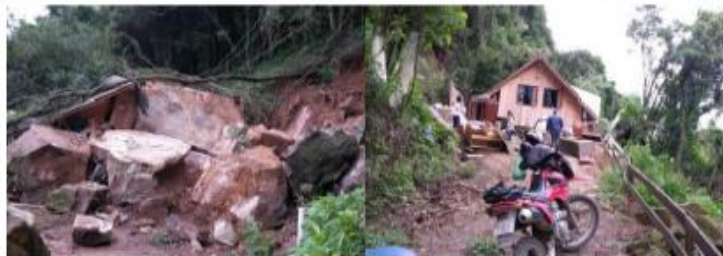
Figura 27. Ocorrência de deslizamento com queda de blocos atingindo uma residência em 2015. Fotografia cedida pela Defesa Civil Municipal.
