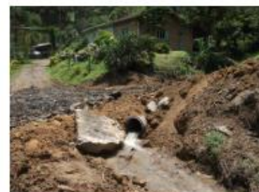
Figura 38. Situação pretérita de drenagem que ocasionou diversos eventos de inundação de duas residências a jusante. Fotografia: Defesa Civil de Alfredo Wagner.
