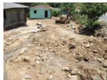
Figura 37. Evento pretérito de enxurrada que atingiu residências a jusante de obra de drenagem. Fotografia: Defesa Civil de Alfredo Wagner.
