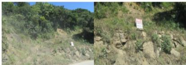
Figura 29. Lote com registro de queda de blocos atualmente desocupado.
