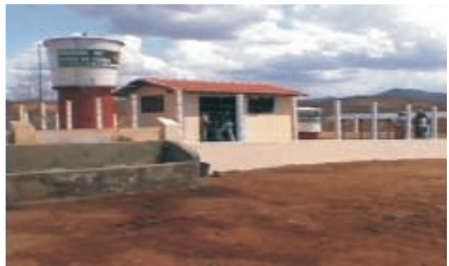
Sistema de captação e dessalinização de água subterrânea por meio de energia solar, município de Irauçuba, CE.
